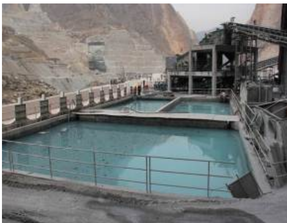
850 二次筛分污水处理沉淀池
