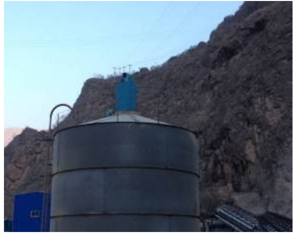
胶凝材料罐顶部收尘箱
