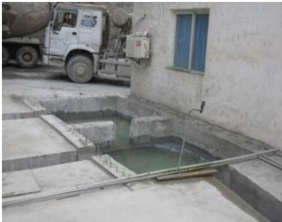
880 砼拌和系统废水沉淀池
