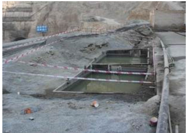
850 砼拌和系统废水沉淀池
