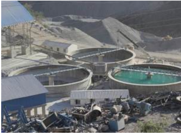
下白滩砂石料系统辐流式沉淀池
