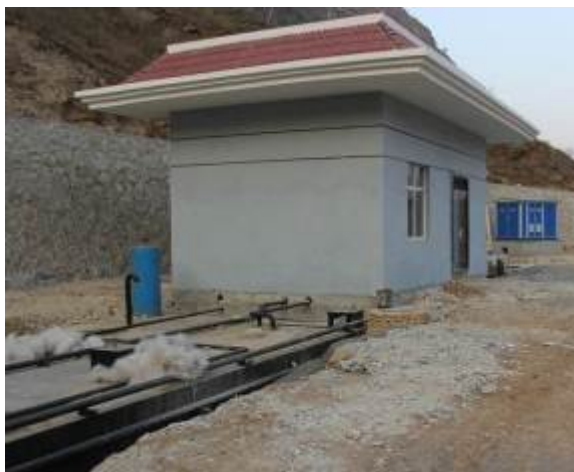
海子尾巴地埋式污水处理站
